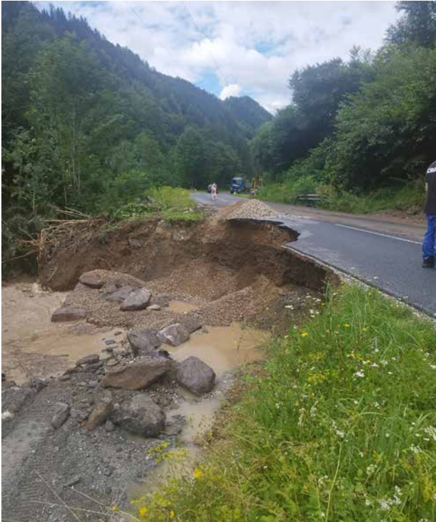
Straßenschäden, Unterspülung in Leppen
