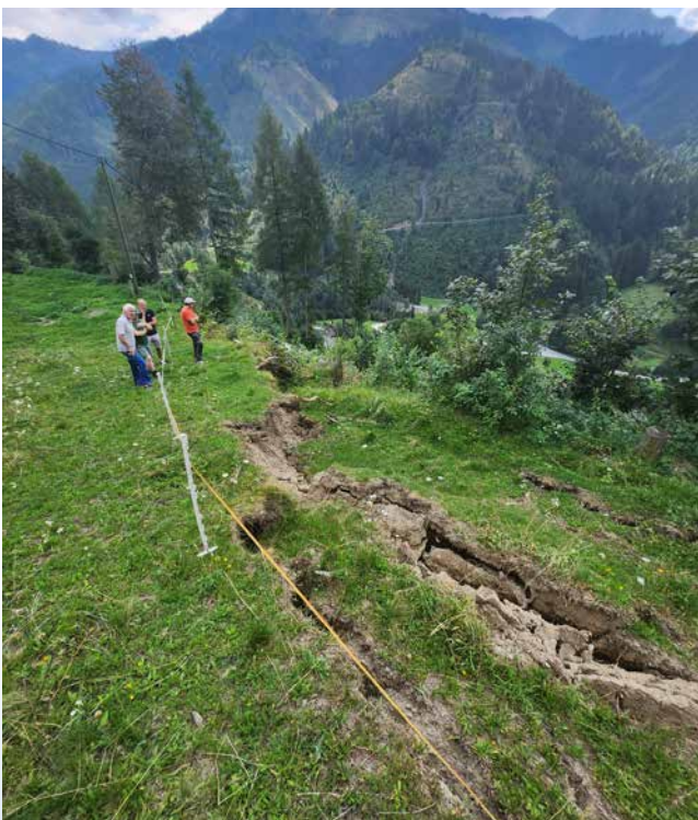
Hangrutschung und Straßenbeschädigung Oberhofer-Blajs
