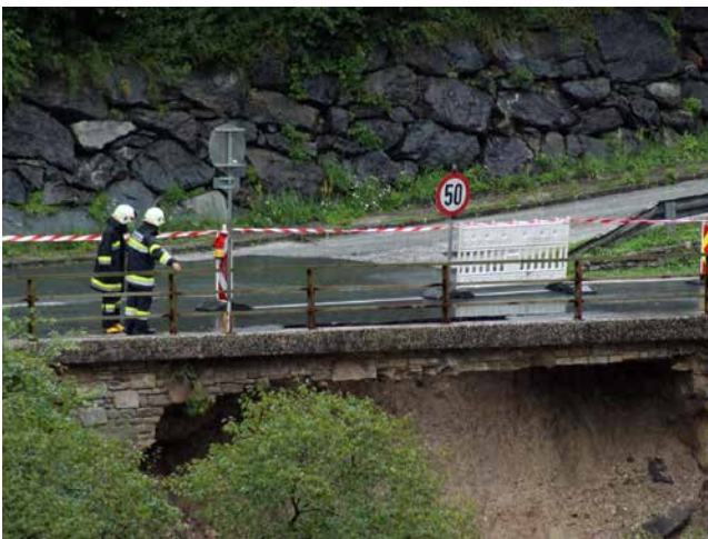
Unterspülung Landesstraße Höhe Rechberg Auffahrt
