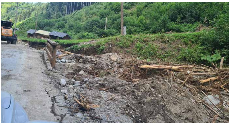
Schäden in Remschenig
