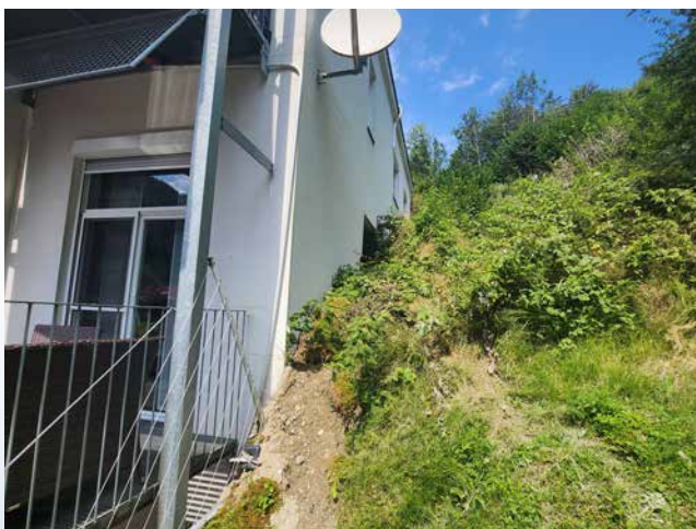
Erdbeben im Ortsgebiet, Wohnhaus Reinwald
